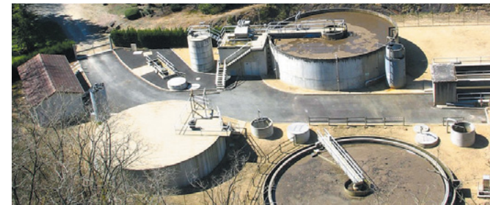
Bassins de décantation de la station d'épuration de Nérès-les-Bains (Allier). En France, la plupart des eaux usées subissent ce type de traitement, au cours duquel certains nutriments sont concentrés dans des boues d'épuration, tandis que d'autres sont volatilisés ou rejetés dans le milieu naturel. Crédits : Toucassé, CC BY-SA, Wikimedia Commons.
